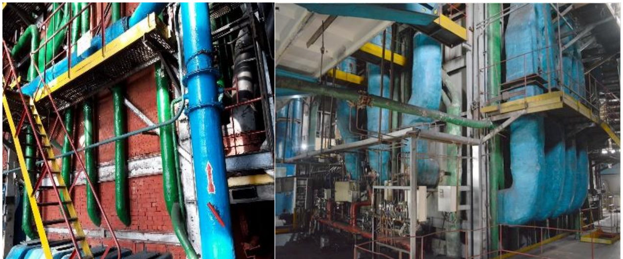
Зураг 81. ТС-42,5-39БД эрчимжсэн буцлах давхаргад зуух
